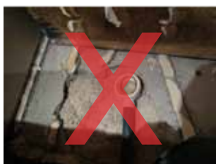
BASE SOPORTE INCORRECTO
